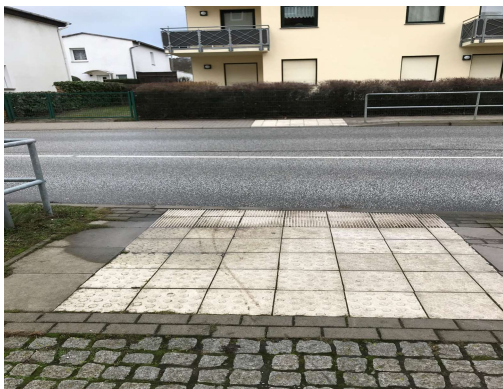
Übergang über die Cubanzestraße (Vorschlag: Zebrastreifen anbringen)
